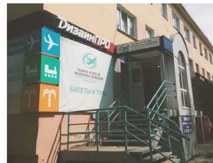
Баннер и элементы, перекрывающие часть фасада
